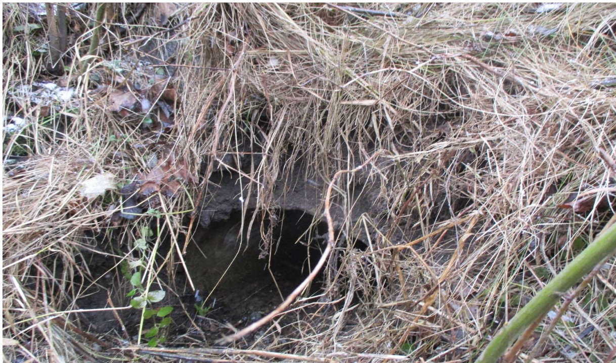
Фото 13. Труба на канале без названия под автодорогой пос. Орехово-пос. Майский в верхнем течении
