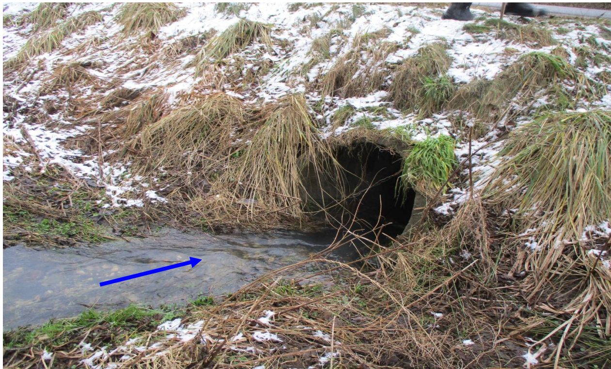
Фото 6. Трубопереезд на автодороге пос. Приморье- пос. Орехово в русле канала БМ-7-2 в верхнем течении
