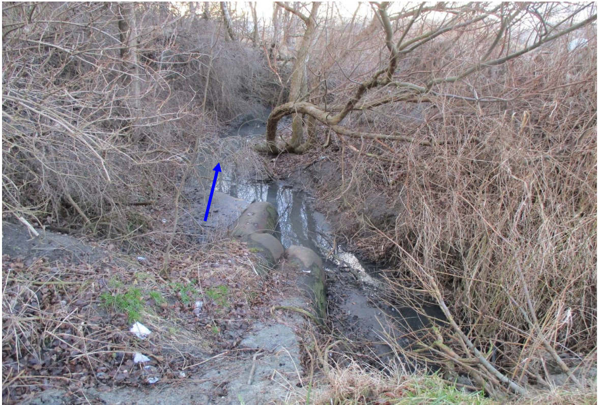
Фото 24. Сбросные трубы фекальной и ливневой канализации в русло канала БМ-3-1
